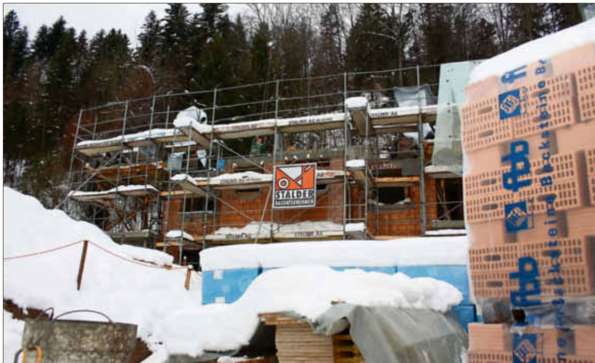
Zurzeit sind die Arbeiten am Rohbau im Gang. Im Sommer 2013 soll das Pfarrhaus fertig sein. Bild: Regula Lienin
